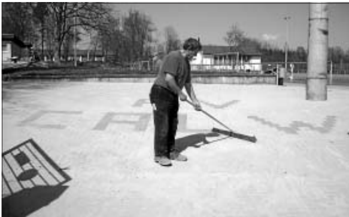
Rechtzeitig zum Osterfest wurde der Eingangsbereich zum Kunstrasenplatz neu angelegt. Unter Leitung von Schorsch Feher und Ivan Kaposta wurde somit die letzte Baulücke der Anlage fertiggestellt.
