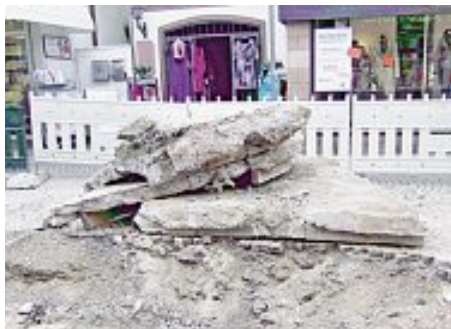
Die Betonplatten erschweren die Arbeiten
