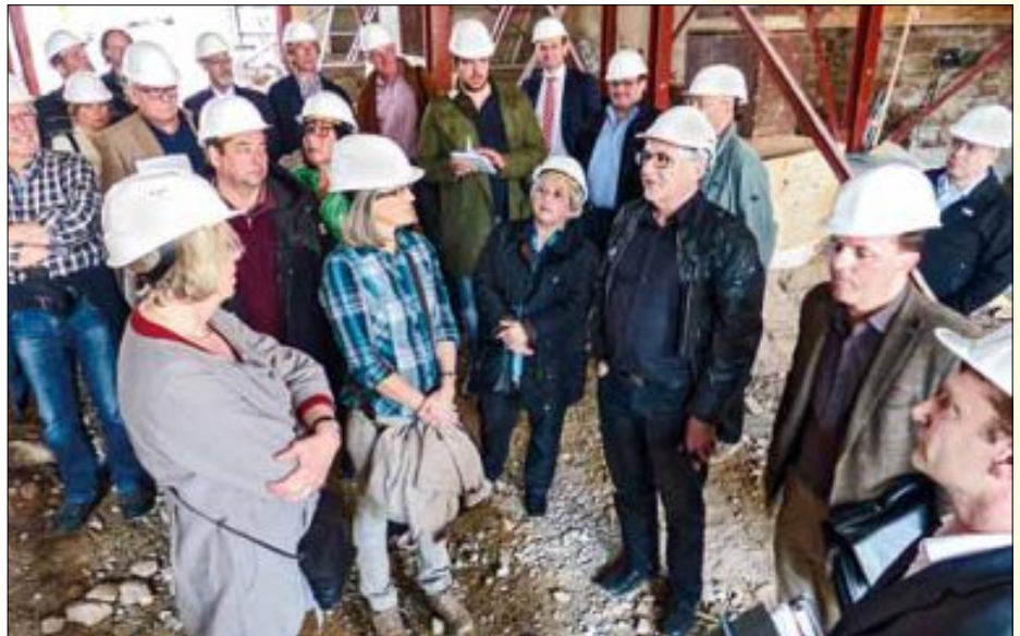
Die Mitglieder des zuständigen Gemeinderats-Ausschusses machten sich vor Ort ein Bild vom Stand der Bauarbeiten im historischen Rathaus bzw. dem „Quartier Unterer Marktplatz“
